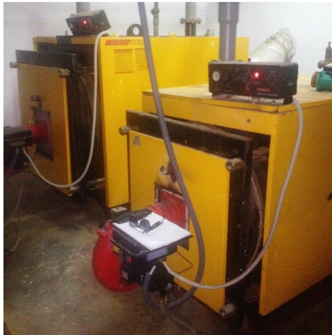
Σχήμα 2.2.2. Λέβητες πετρελαίου κίνησης εγκατεστημένοι στο λεβητοστάσιο του κλειστού κολυμβητηρίου
