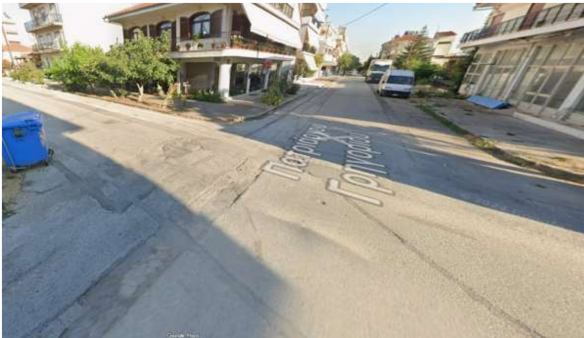
Εικόνα 3: Φθορές στο οδόστρωμα της οδού 40 Εκκλησιών και Πατριάρχου Γρηγορίου στην Ορεστιάδα
