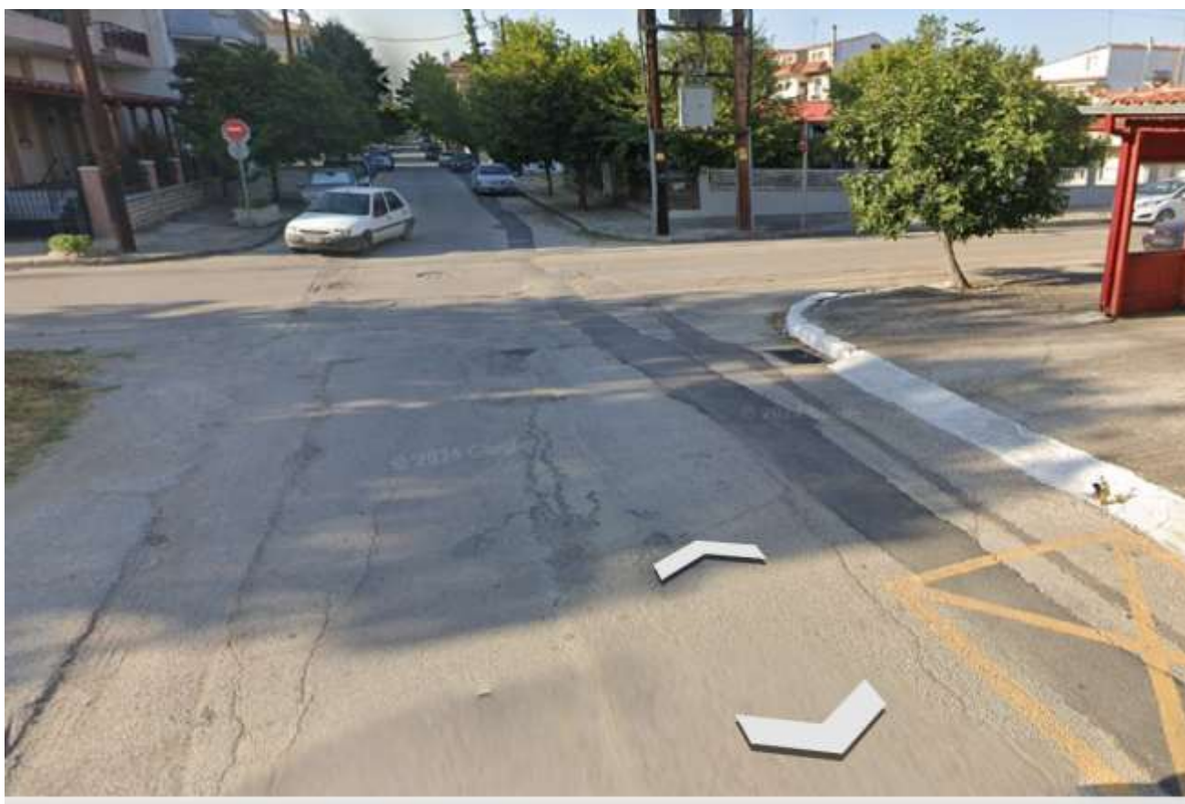
Εικόνα 4: Φθορές στο οδόστρωμα της οδού Αγ. Θεοδώρων στην Ορεστιάδα
